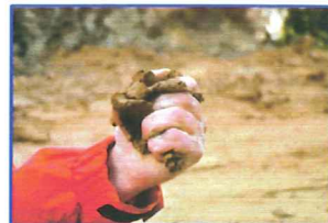
Neben umfangreichen Labortests wird das Lehmmaterial vor dem Einbau auch per Hand auf seine Tauglichkeit hin untersucht.
