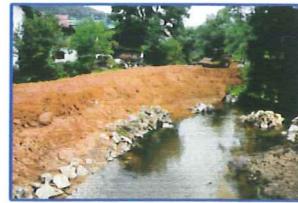
Schichtweises Aufschütten des Deiches zu je 30 cm und Verdichtung mit der sogenannten Schafffußwalze.
