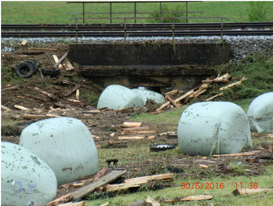
Mit Silageballen und Brennholz verstopfter Durchlass unter Bahnlinie zwischen Ansbach und Wuerzburg bei Oberdachstetten (Bildquelle: Wasserwirtschaftsamt Ansbach)
