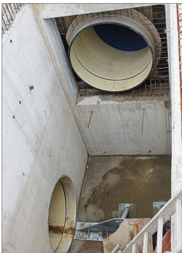
Ein Blick ins Schöpfwerk I: Im Hochwasserfall läuft das Niederschlagswasser aus dem Rohr am oberen Bildrand und kann sich nach links ins Rückhaltebecken aufstauen.
