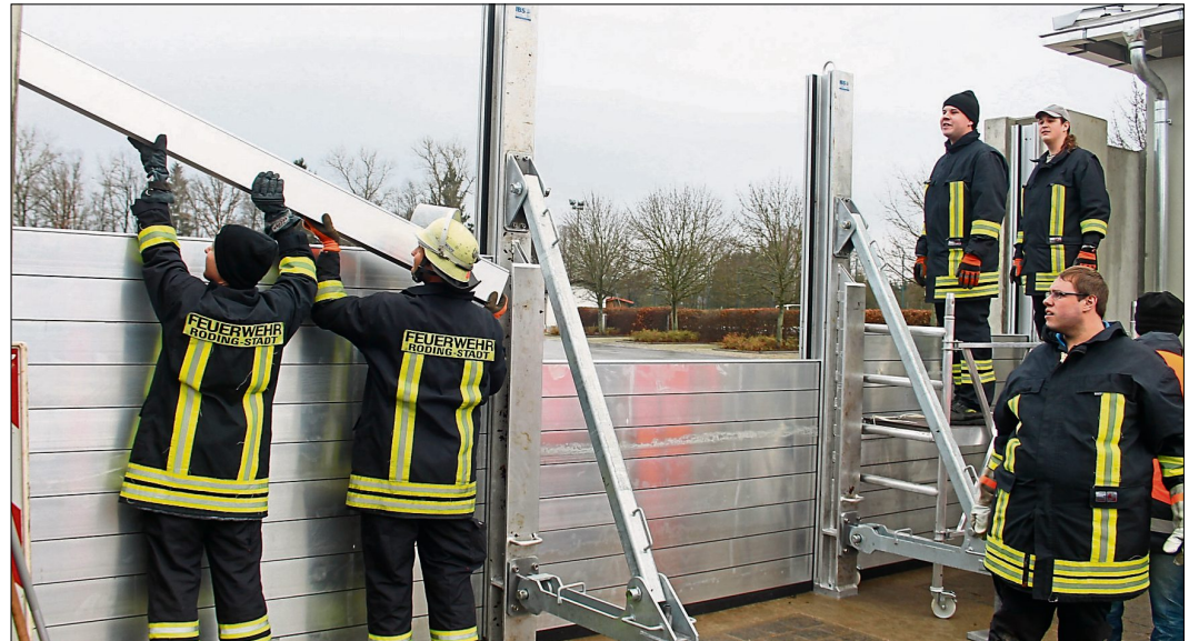
Die Rodinger Feuerwehrmänner setzten Dammbalken für Dammbalken bis zu einer Höhe von 3,5 Metern. Etwa zwei bis vier Stunden sind für den Aufbau des gesamten Hochwasserschutzsystems angesetzt.
