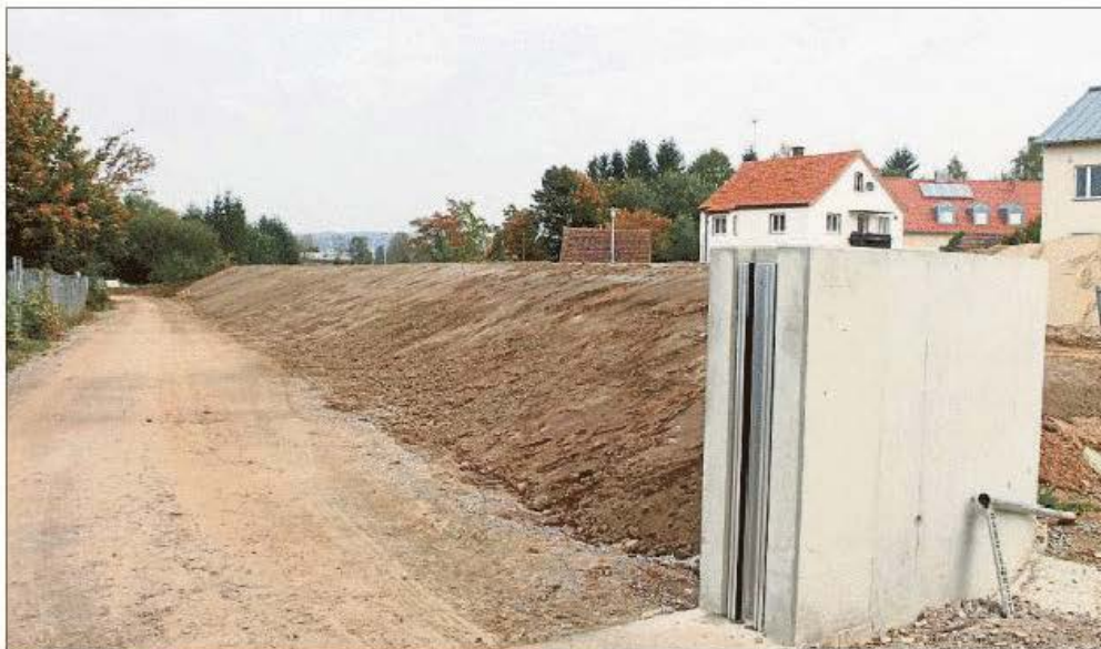
Die Aufschüttung des Deiches bis zum Bereich des Sportplatzes ist abgeschlossen. Es fehlt nur noch die Begrünung.
