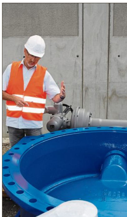
Stättliche Dimensionen bei den Ruhrleitungen.
