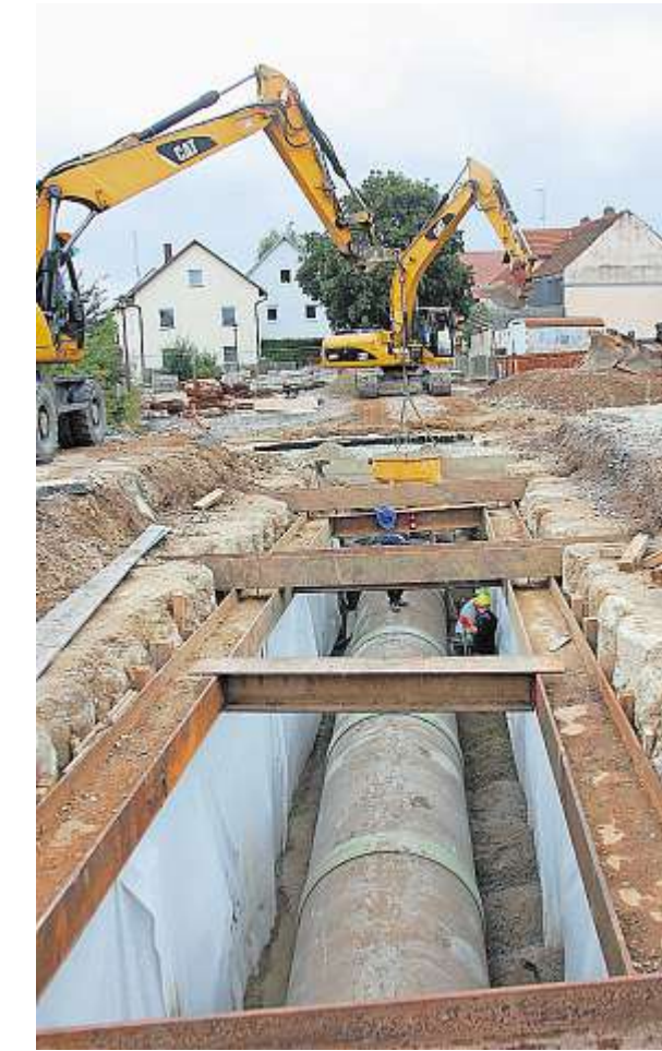
Die Rohrleitung zwischen Pumpwerk und Überlaufbauwerk mit einem Durchmesser von 1,60 Meter
