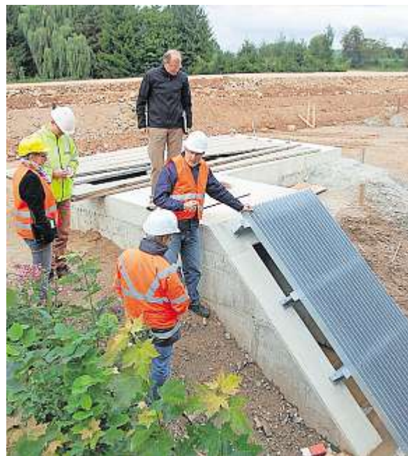
Das Pumpwerk 2 ist etwa in der Mitte des Deichs.
