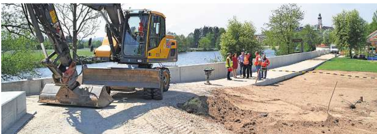
Teile des Bades werden bei Eröffnung noch nicht nutzbar sein. Doch große Maschinen werden nicht mehr da sein.
