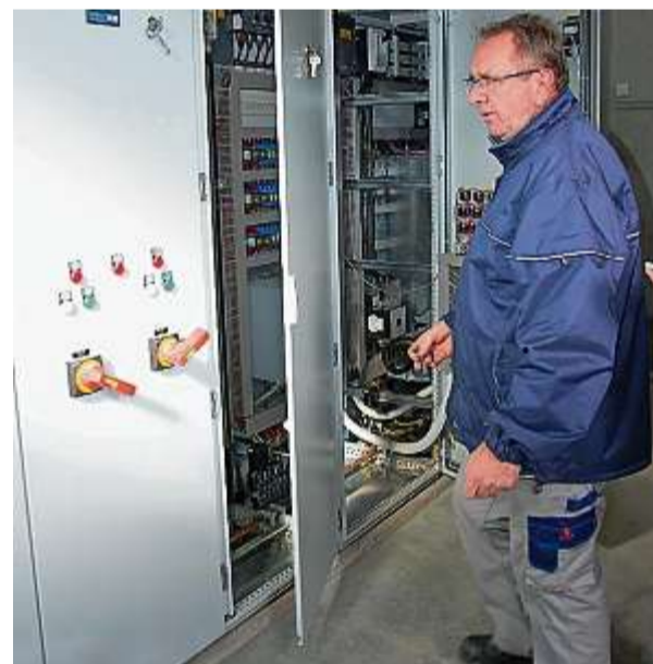
Klärwärter Willi Ederer im Schaltgebäude, die Installation ist weitgehend abgeschlossen.
