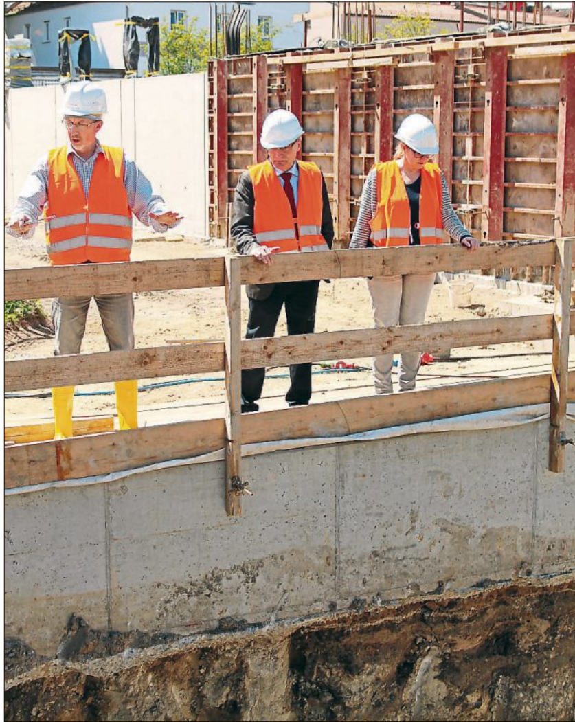
Am Abgrund – Alfons Lerch, Bürgermeister Franz Reichold und stellvertretenden Stadtbaumeisterin Sabine Weixel vor der Grube, in die das Schöpfwerk I gebaut wird.
