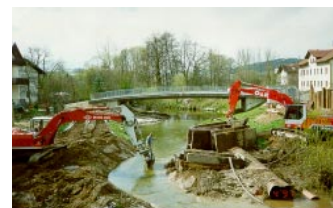
▲ Die alte Brücke über den Klinglbach lag viel zu niedrig und stellte ein erhebliches Abflußhindernis dar. Als Ersatz dafür entstand die im Hintergrund abgebildete neue Brücke. Die Baggerarbeiten dienen zur Herstellung der Gewässerkreuzung für die Binnenentwässerung.
