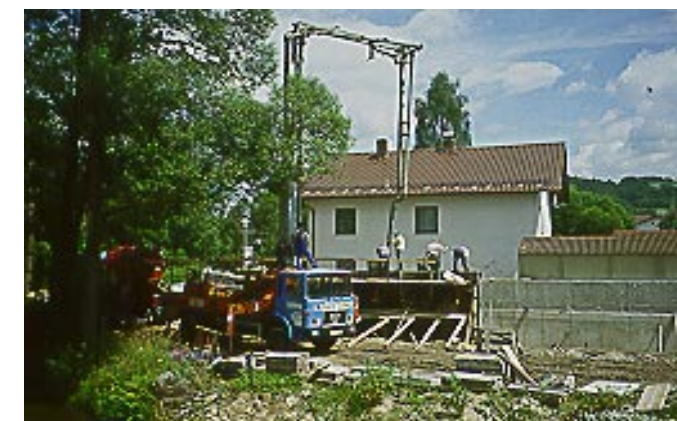
▲ An schwierigen Engstellen mußten Hochwasserschutzmauern errichtet werden, die sowohl gestalterisch als auch baulich an die vorhandene Altbebauung möglichst optimal angepaßt wurden.
